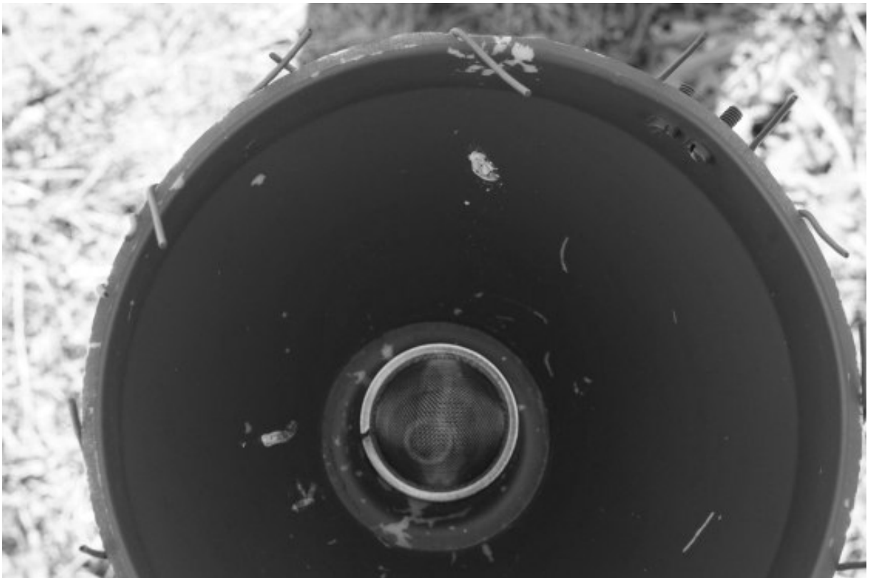
Abbildung A.3: Durch Vogelkot verunreinigter Wickelschlauchsammler am 17.09.2018 in Pirna.
