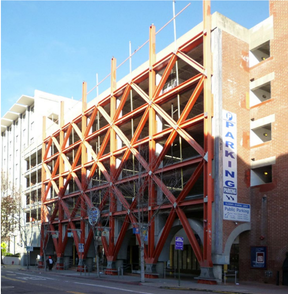
Figura 3. Esoscheletro metallico antisismico intorno al parcheggio in cemento armato di Berkeley California. I controventi a X sul fronte della struttura sono stati aggiunti dopo il completamento dell'edificio per aumentare la resistenza alle azioni orizzontali, https://miraimages.photoshelter.com/image/I0000npJsJdoH3Zw (ultimo accesso 12 febbraio 2019).
