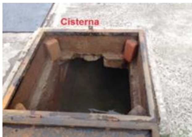
Figura 2. Fotografía de la cisterna de almacenamiento de agua termal que surte el Balneario "El Tingo". Provincia de Pichincha, Ecuador
