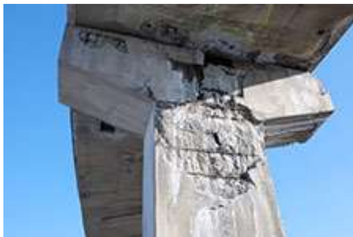
Figura 2. 2. Fallas de concreto Portland
