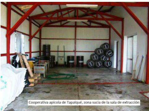
Ejemplo de zona sucia en sala de extracción.
