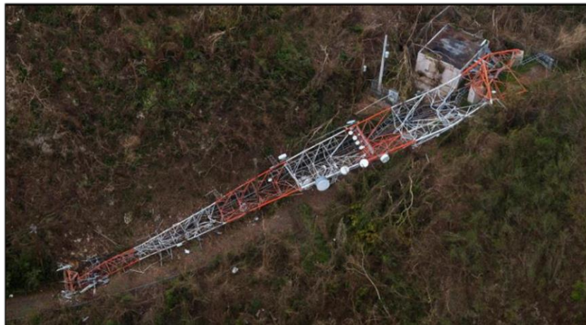
Figura 5. Torre colapsada, Arecibo Puerto Rico
