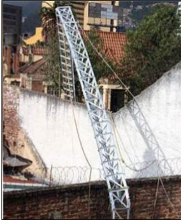
Figura 7. Torre colapsada, Bogotá D.C
