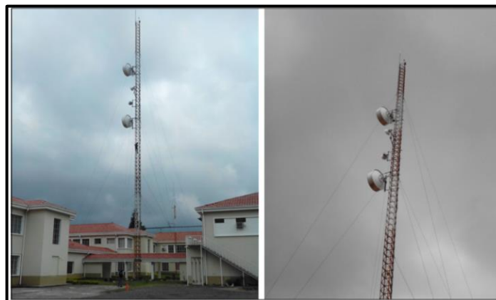
Figura 13. Torre atirantada, Ibagué Tolima.
