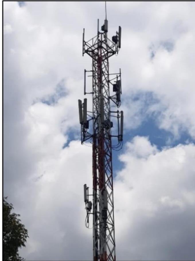
Figura 15. Torre autoportada, Bogotá D.C
