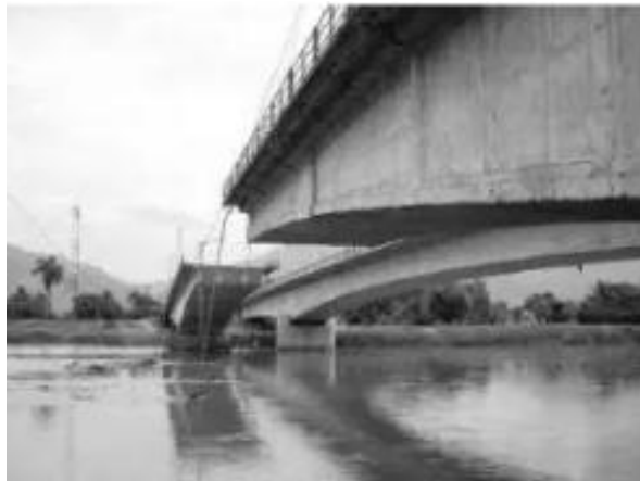
Imagen 7. Colapso total del tramo central del puente La Democracia producto del giro de sus bastiones y de la corta meseta de apoyo-Honduras.
