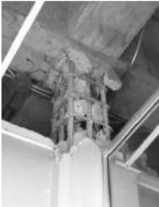
Imagen 10. Fallo por columna corta-Honduras.
