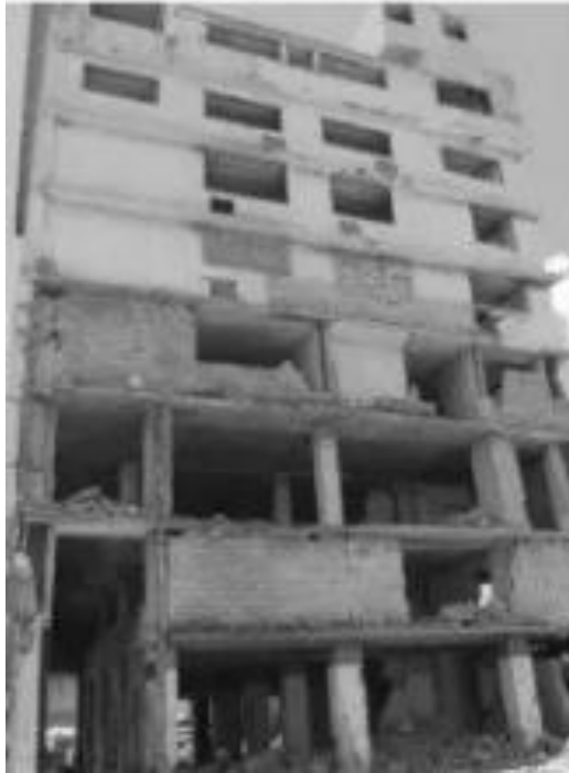
Imagen 8. Daño en muros debido a problemas de irregularidad-Haití.
