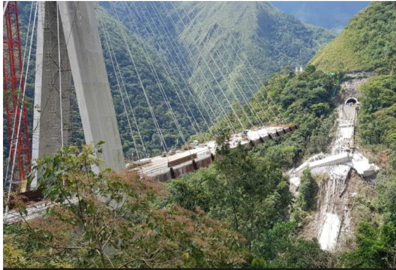
Imagen 23. Ejemplos de puentes colapsados por deficiencias estructurales.
