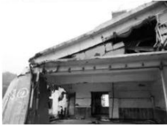
Imagen 6. Colapso del segundo piso y afectación del primer piso debido a la irregularidad en planta de la edificación-Japón.
