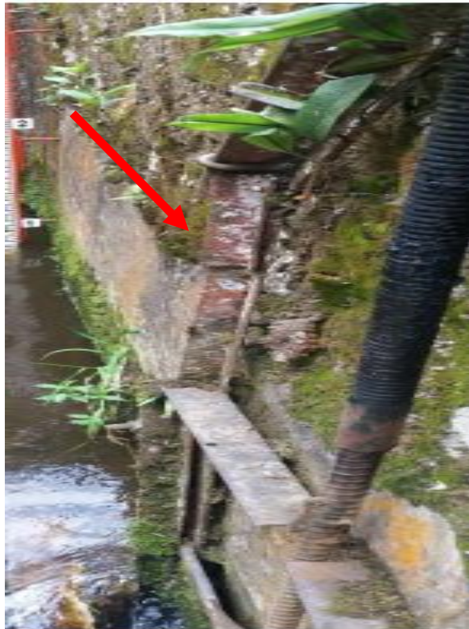
Imagen 16. Fallas de la compuerta Bocatoma – Aducción.
