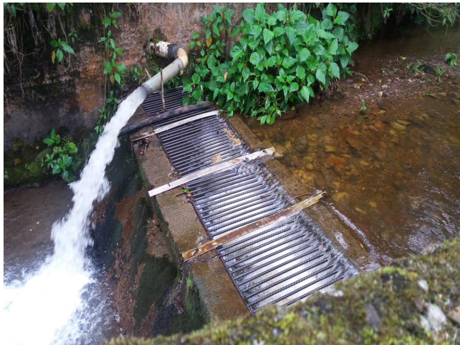
Imagen 9. Captación Río Barro Blanco.
