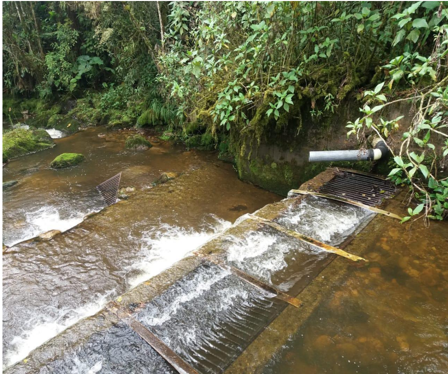
Imagen 13. Rejilla de Captación.
