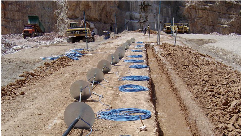
Imagen 39. Extensómetro de Terraplén
