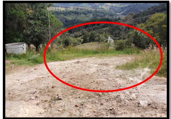
Fotografía 17 Punto Crítico 6-B
