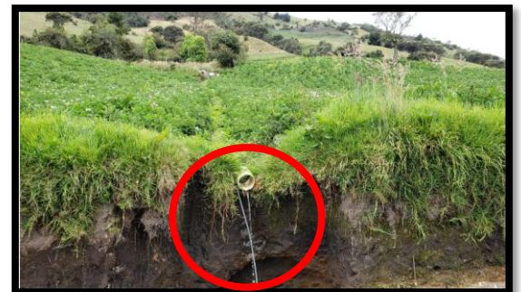
Fotografía 11 Punto Crítico 3-B
