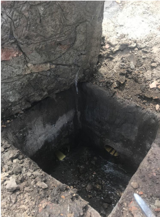
Figura 13. Caja de inspección existente.
