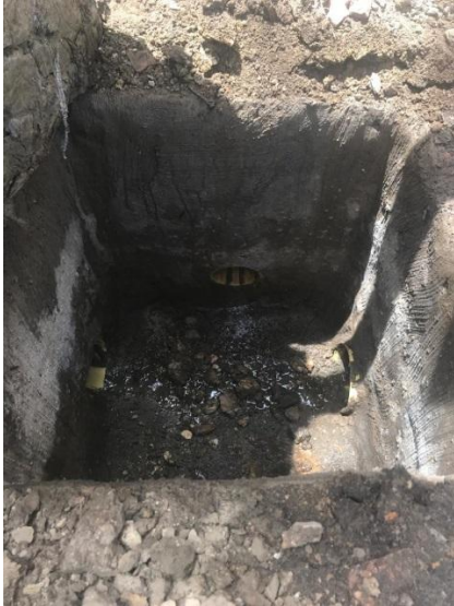
Figura 14. Caja de inspección existente
