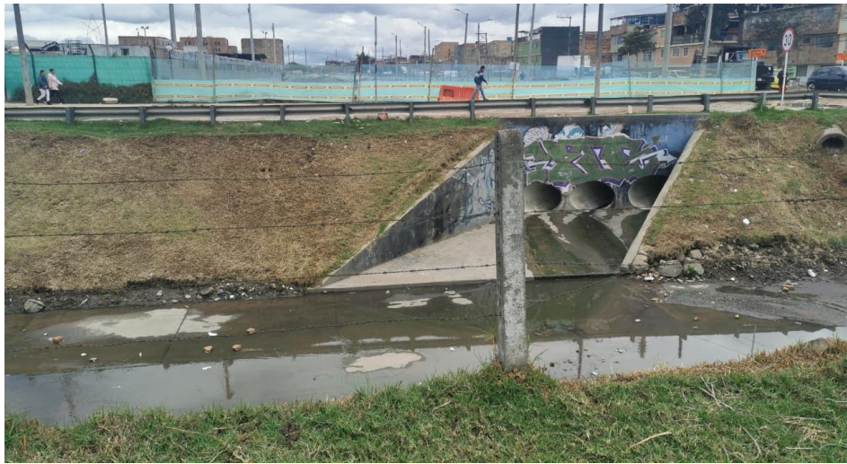
Figura 2-16. Colectores de descarga existentes del área de estudio Fuente: Autores
