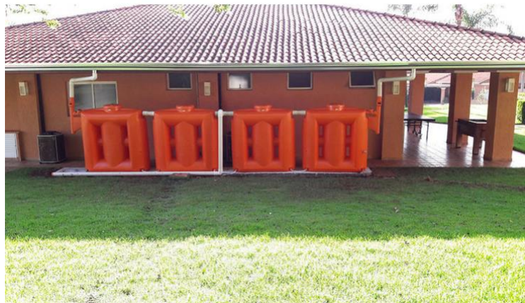
Figura 4 Tanques exteriores modulares, Fuente: (“5 sistemas para aprovechar el agua lluvia, 2017).
