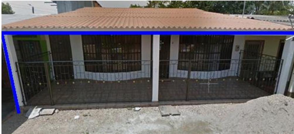
Figura 36 Canaletas para captación de aguas lluvias por cubierta, Fuente: elaboración propia con imagen satelital de Google Earth.
