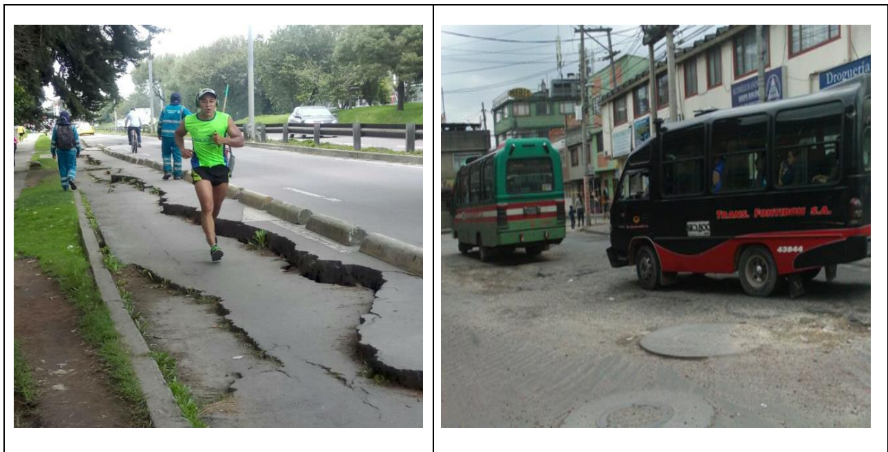
Foto 5-1 Fisuras en bloque y Hundimientos evidentes.
