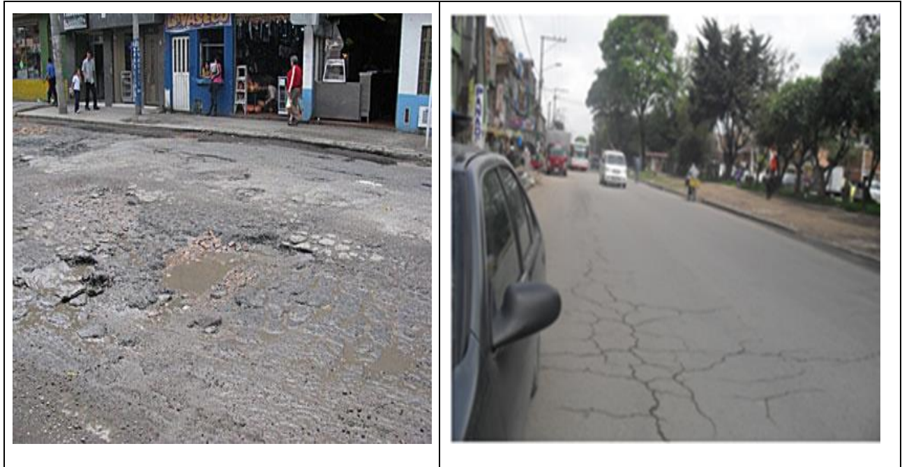
Foto 5-2 Perdida de Agregados y Piel de Cocodrilo
