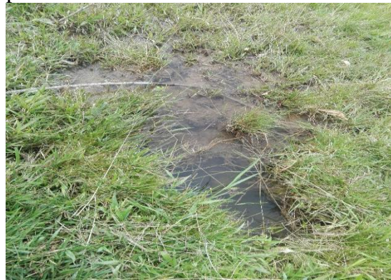
Imagen 28. Daños en la Tubería que generan perdidas
