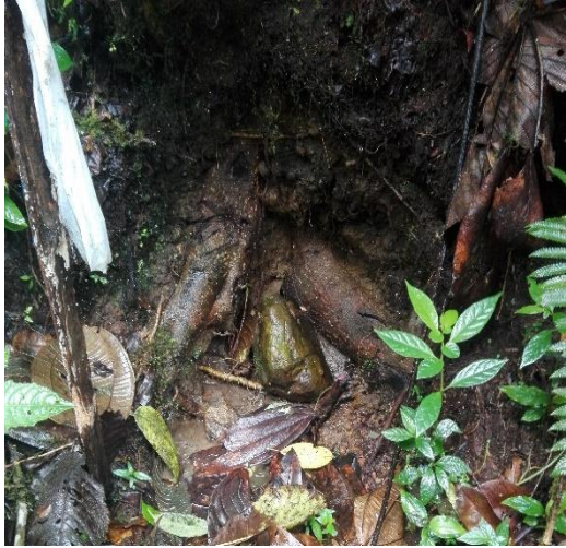
Imagen 17. Ventosa 21, el daño a ido aumentando debido a la raíz del árbol que la rodea.
