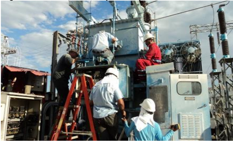
Figura 7. Mantenimiento y montajes eléctricos industriales
