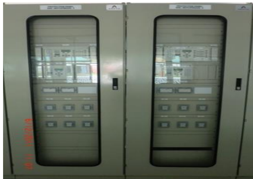
Gambar 4. Panel Proteksi pada Saluran Transmisi 150 kV (Sumber : Dokumentasi Pribadi, 2011)
