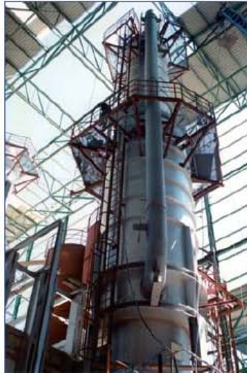
Figura 4.5.25: Horno de recuperación Fuente: SORG (Ref. 48)
