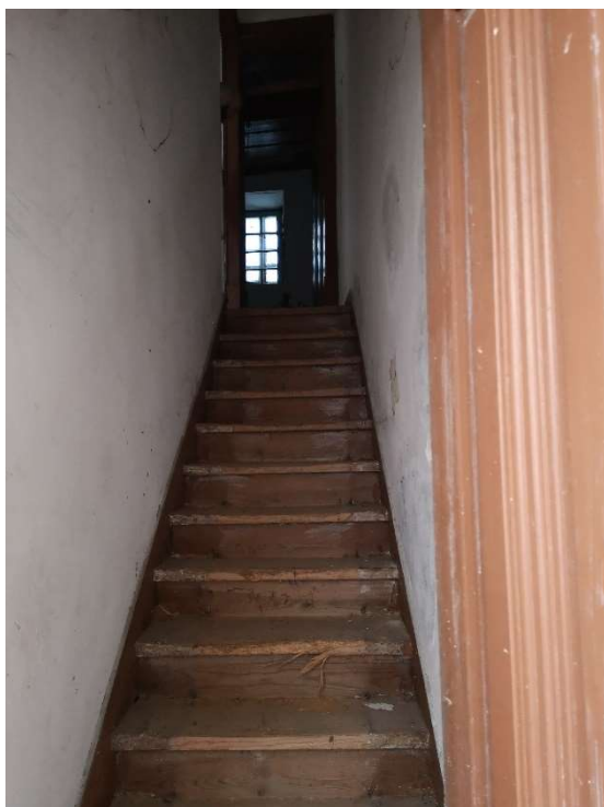
Figura 27 - Fotografia do interior do edifício LR-Z1-B015 [Foto: Tiago Ferreira, PhD, 2019]
