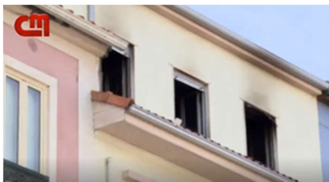
Figura 14 - Apartamento já consumido pelo incêndio do dia 7 de Dezembro de 2017, [Correio da Manhã, Dezembro de 2017]
