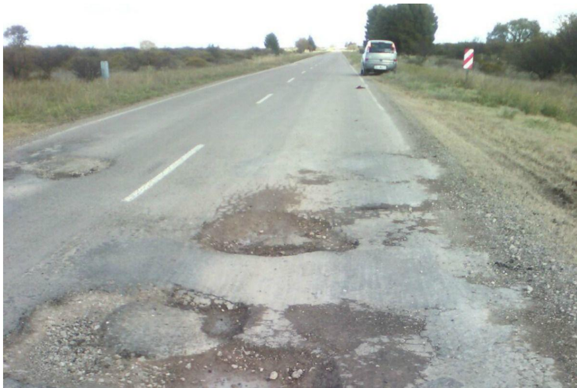
Figura 8.9. Estado de la ruta nacional 152, La Pampa. Fuente: fotografía de Agencia de Noticias Roca (2016).
