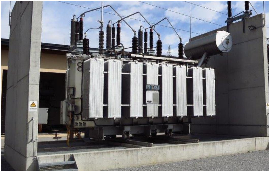
Abbildung 10: Leistungstransformator 50 MVA 110/30 kV mit Lastregelschalter links integriert
