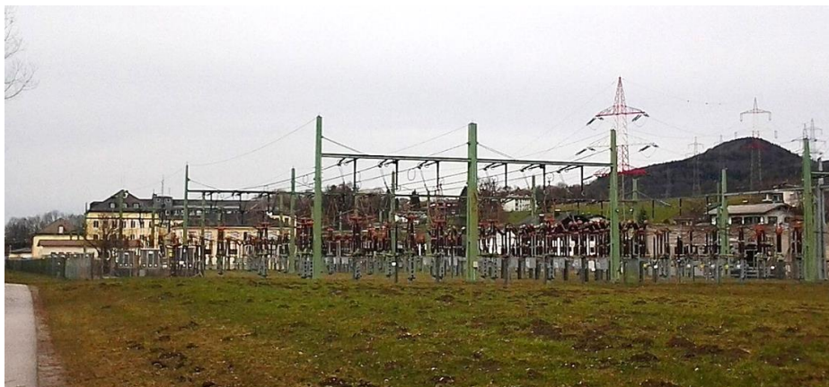
Abbildung 5: Umspannwerk Salzach 220/110 kV und Gebäude Umspannwerk Hagenau 5
