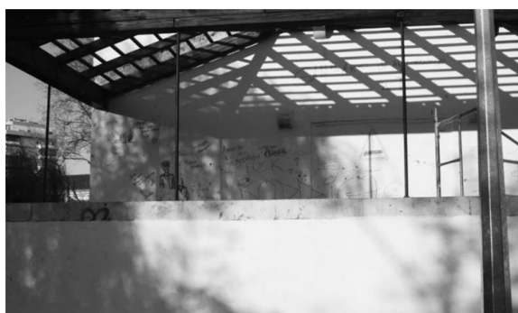
Figura 13 - Alpendre, onde se localizava o painel azulejar de São Pedro de Alcântara, atualmente preservado no acervo devido às ameaças de vandalismo, 2019.
