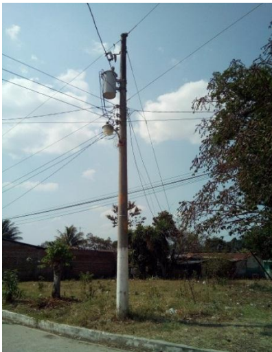
Imagen 15. Poste de alumbrado eléctrico. Fuente: Propia.
