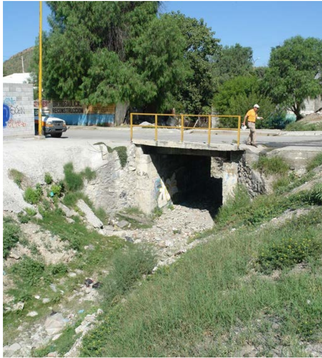
Figura 189. Ejemplo de infraestructura obstruyendo el arroyo.
