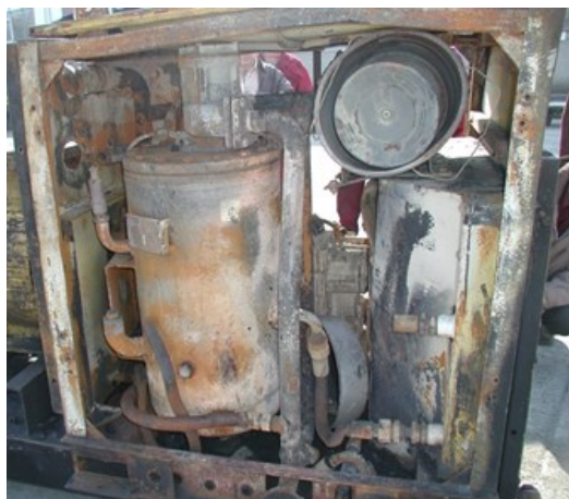
Obr. 2-3 Havarovaná kompresorová jednotka se šroubovým kompresorem [3]
