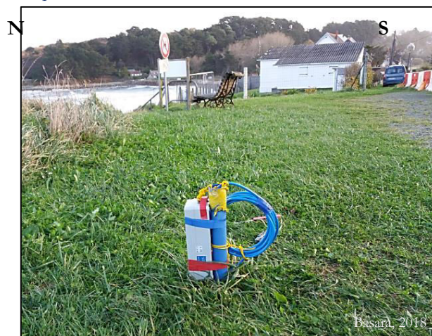
Fig. 149 : Sonde piézométrique installée en sommet de falaise sur le site de Locquirec (vue depuis l'ouest).
