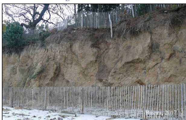
Ganivelles installées en pied et au sommet de falaise pour prévenir des dangers d'éboulement (Fouesnant, 29)
