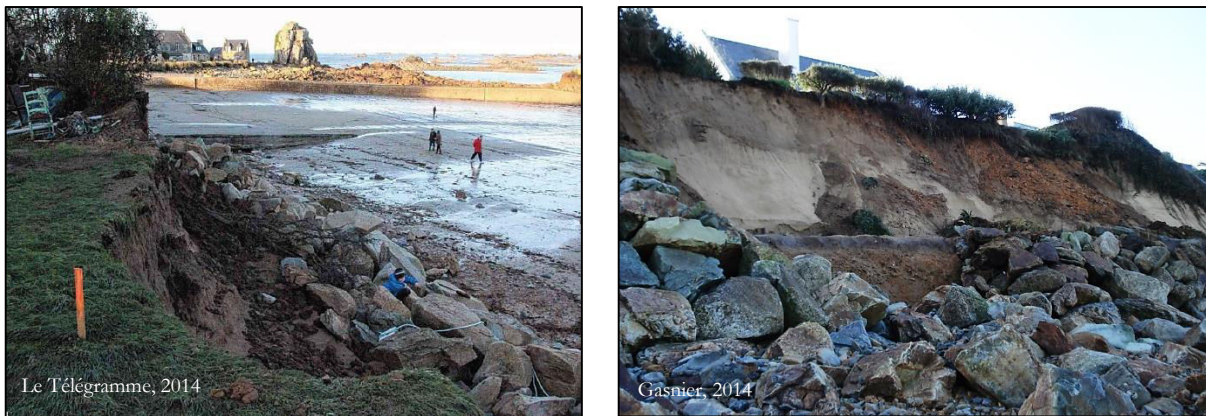
Fig. 241 : Enrochements détruits à la suite des tempêtes de février 2014 et érosion des terrains en arrière, sur le site de Pors-Hir, à Plougrescant (photo de gauche) et au Moulin de la Rive, à Locquirec (photo de droite).
