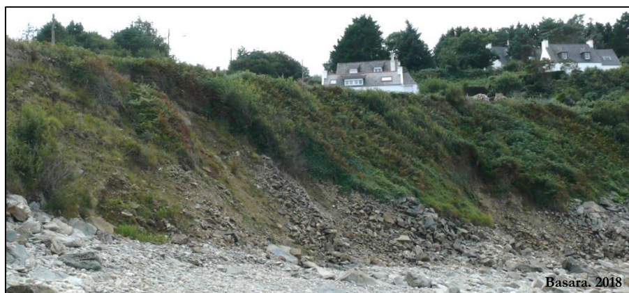
Fig. 187 : Glissements affectant les falaises situées à l'ouest du site et recouvertes par du remblai. Vue depuis le nord-est.
