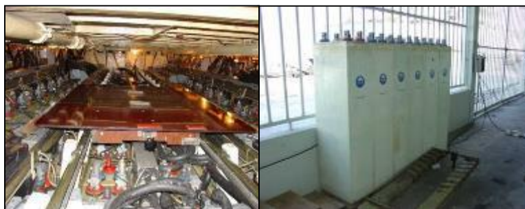
Figura 9 - Praça de Baterias de um submarino convencional à esquerda e Elementos de Bateria à direita.
