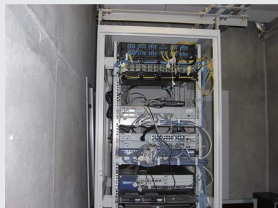
ネットワーク機器 Equipments for network system
