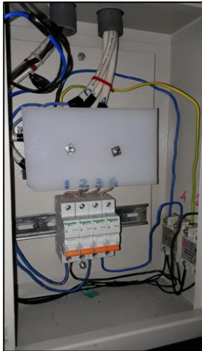
Gambar 3. Panel kendali pemanas Untai FASSIP-02.
