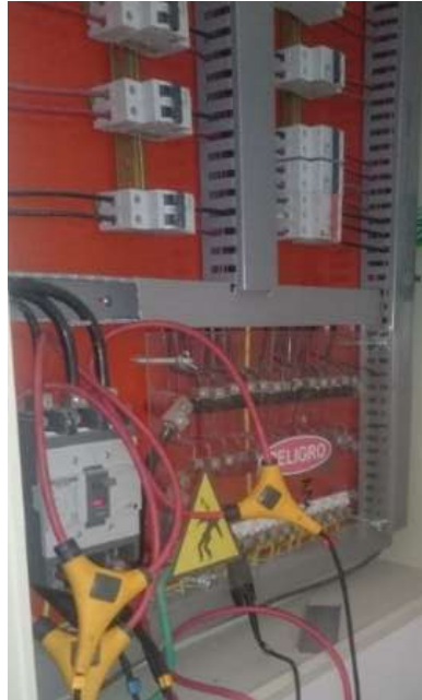
Figura 18. Tablero Principal del Edificio Nuevo.
