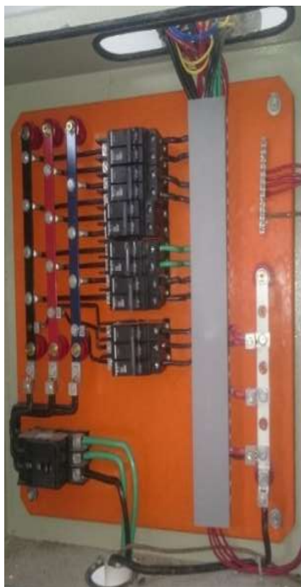
Figura 19. Tablero principal de los Laboratorios.
