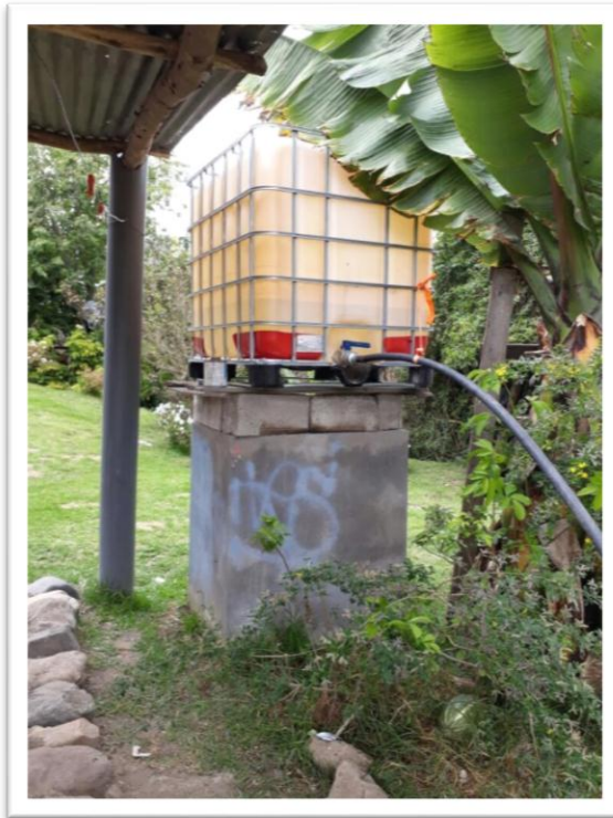
Figura 19: Conexiones de tubería
