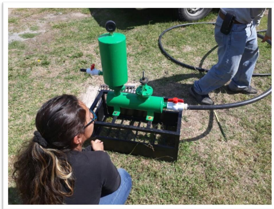
Figura 17: Conexión de mangueras
