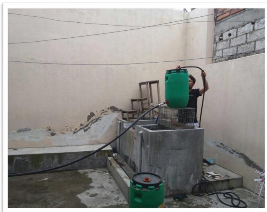
Figura 15: Abastecimiento de agua para primeras pruebas de funcionamiento
