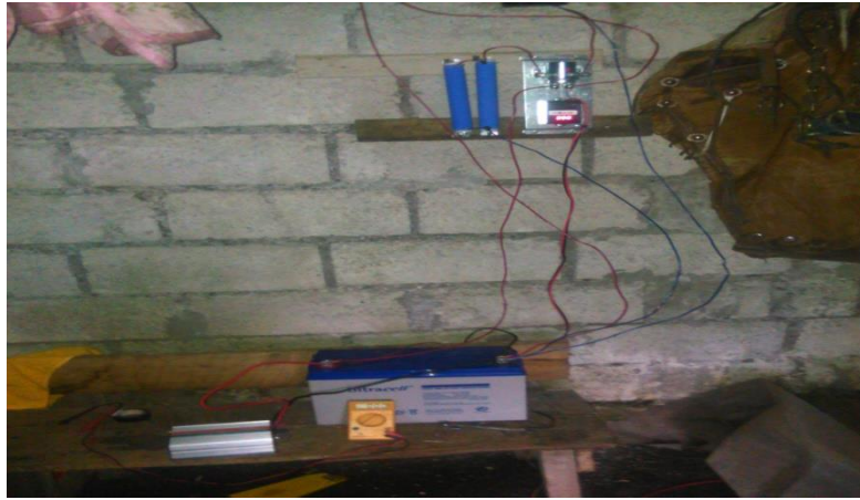
Torre, Aerogenerador y Caja de control
