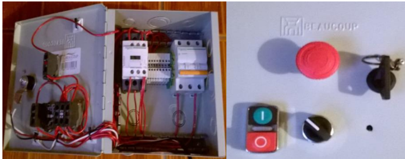
FIGURA 3. 4 Caja de protecciones
