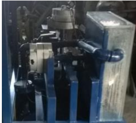
FIGURA 3.31 Implementación de los alternadores de 24V/500W
