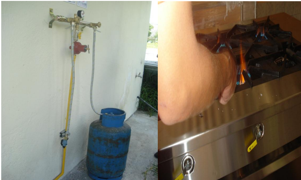
Figura 2. Centralina de gas, operación
