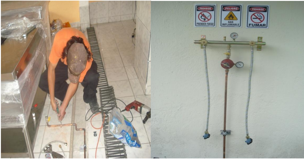
Figura 1. Centralina de gas, instalación
