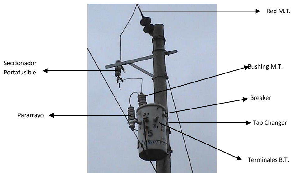
Figura 1.6 Transformador monofásico autoprotegido en poste
