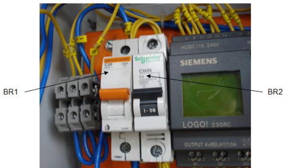
Figura 3.5. Interruptores termomagnéticos unipolares (BR1 y BR2).
