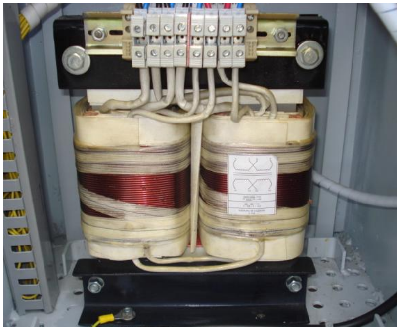
Figura 3.3.- Transformador de aislamiento del equipo para pruebas en transformadores
