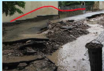
Abbildung 20: Durchfeuchtung des Mauerwerks (mit Welle aufgrund einer Bodenschanze auf der Straße) (IÖR, 2018)
