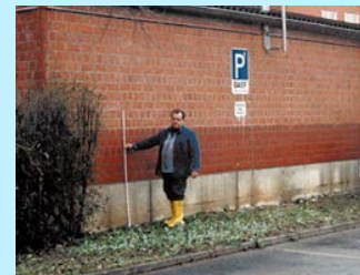
Abbildung 21: Durchfeuchtung des Mauerwerks (Gewässerdirektion Neckar, 2001)
