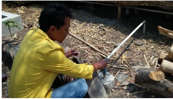
Gambar 8. Pipa biodigester yang menuju ke rumah.
