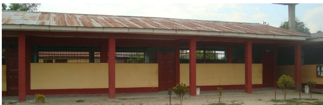
Figura 5. Situación actual de aulas, en pésimas condiciones para brindar servicio (Fuente: expediente técnico del proyecto)
