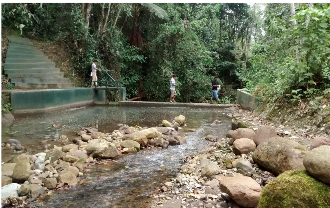
Fotografía 8. Medición en la captación del sistema de agua potable
