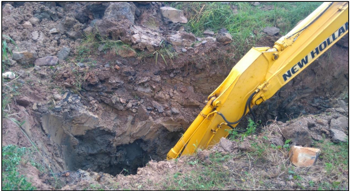
Foto N° 16: En la foto se muestra la excavación de las calicatas con ayuda de excavadora hidráulica en la progresiva km 08+200 de la carretera Shapaja – Chazuta.
