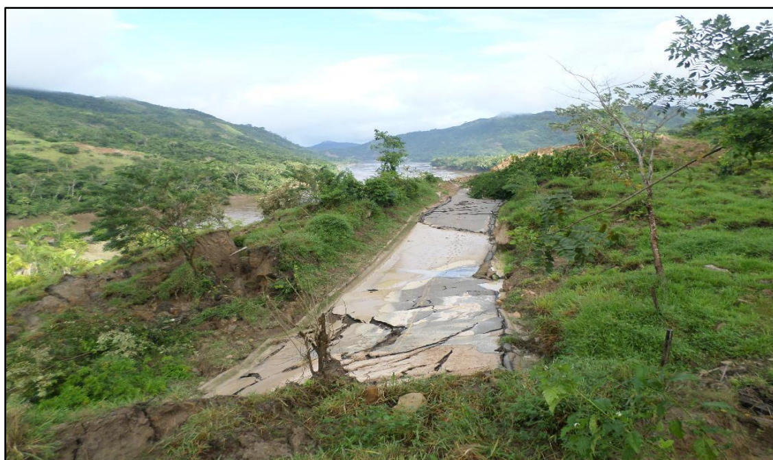
Foto N° 07: En la vista se observa la plataforma totalmente desplazada del eje de la carretera tramo km 08+000 al km 08+300.
