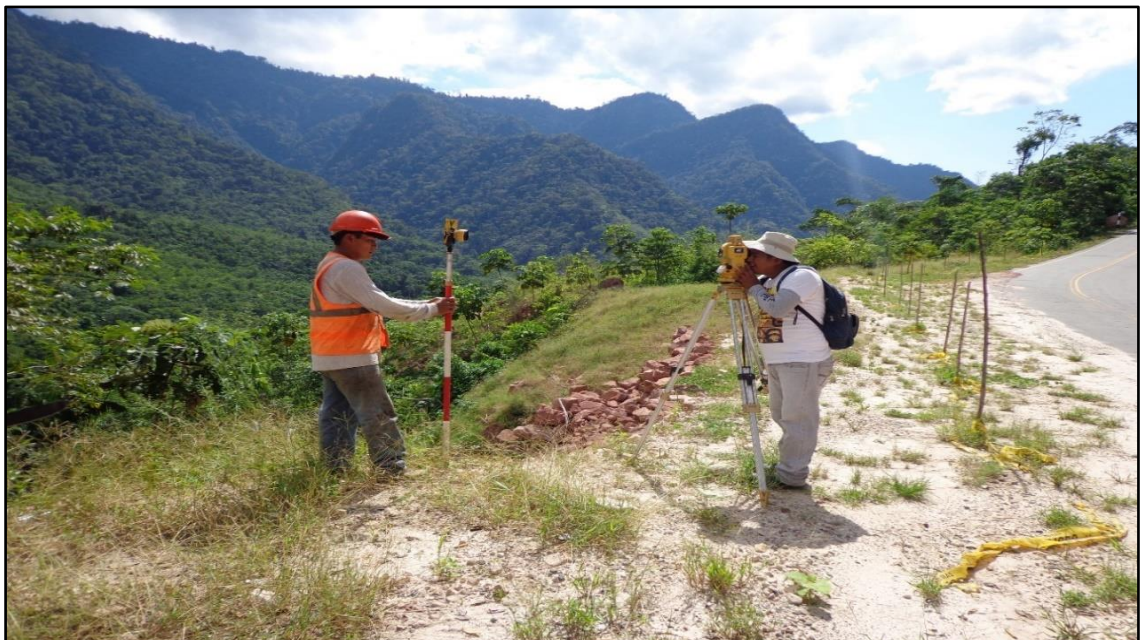
Foto N° 13: En la foto se muestra el levantamiento topografico del tramo en estudio km 08+000 al km 08+300.
