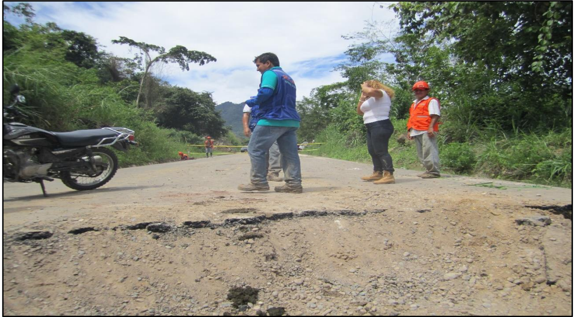
Foto N° 08: En la vista se observa el pase completamente restringido en la progresiva km 08+300 de la carretera Shapaja – Chazuta.
