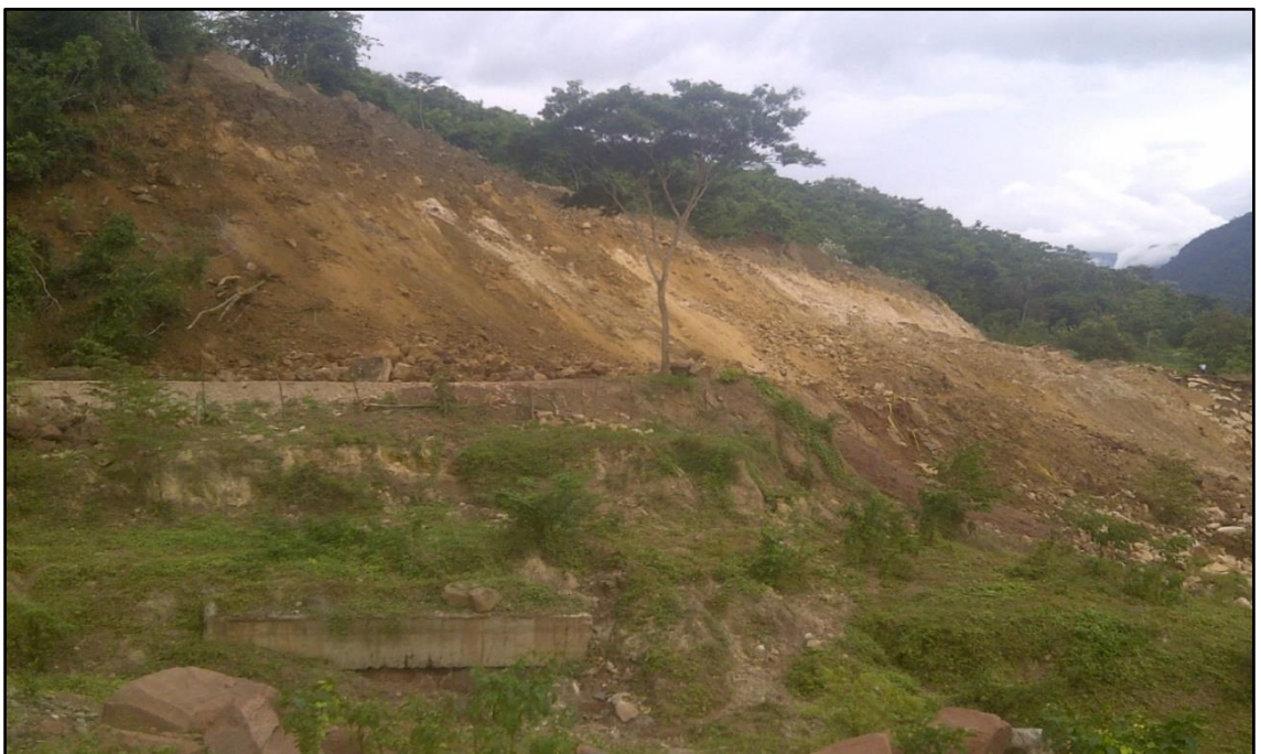
Foto N° 05: Se muestra la magnitud del deslizamiento rotacional tramo km 08+000 al km 08+300 de la Carretera Shapaja – Chazuta.
