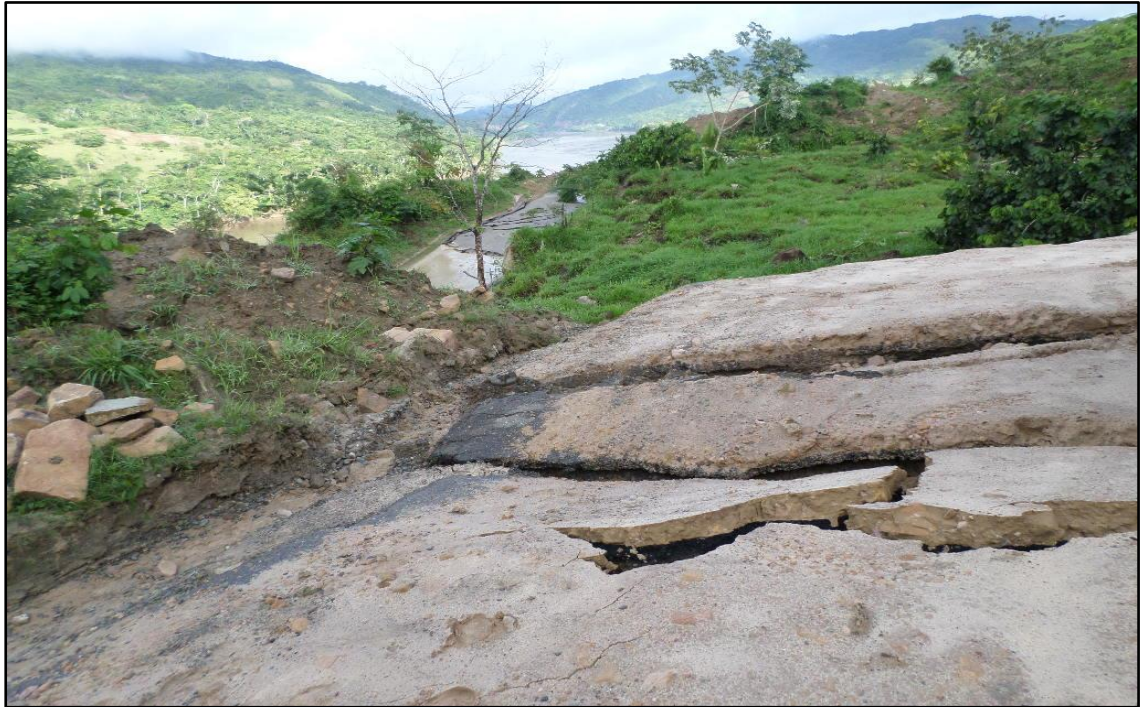
Foto N° 04: Se observa el estado de la carretera completamente colapsada tramo km 08+000 al km 08+300 de la Carretera Shapaja – Chazuta.
