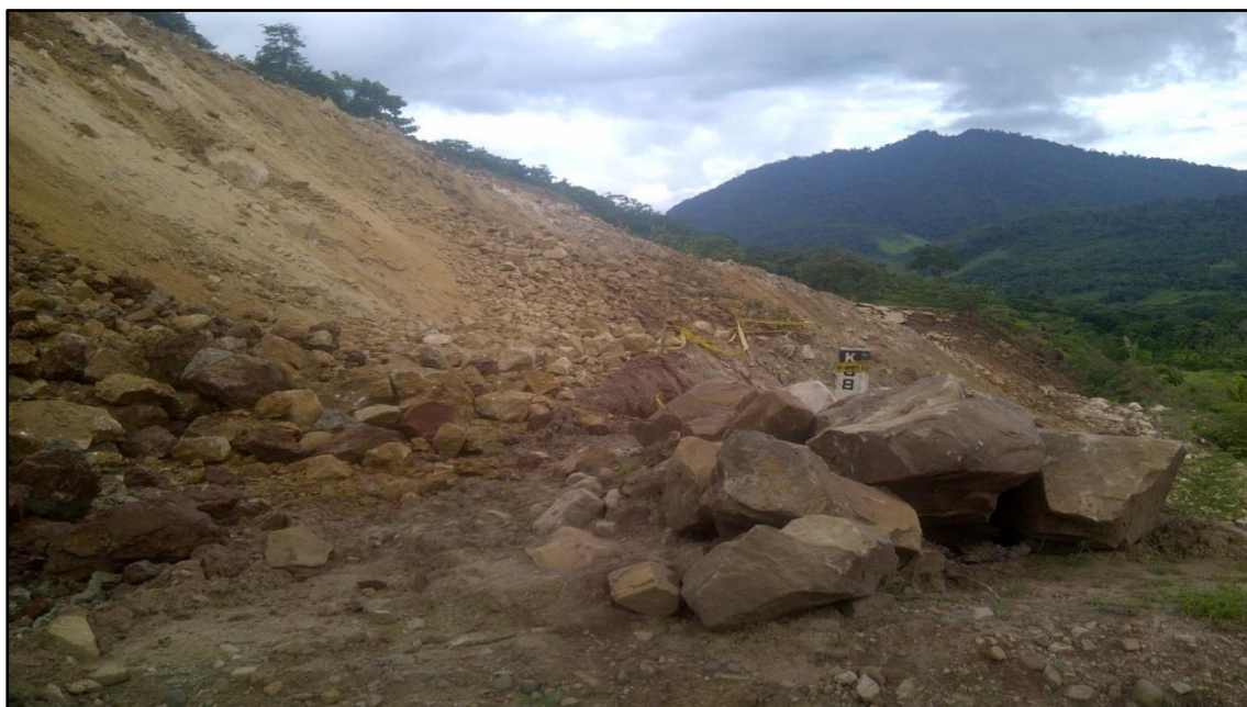
Foto N° 06: Se muestra la variedad del material del deslizamiento rotacional en la progresiva km 08+000 de la Carretera Shapaja-Chazuta.
