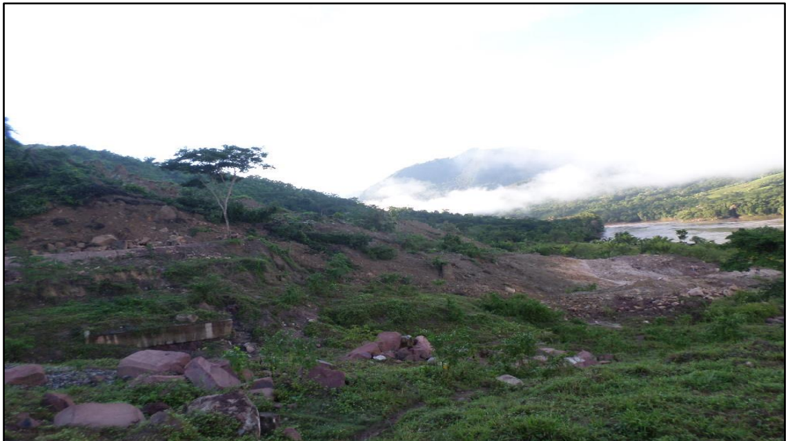
Foto N° 01 : Se observa el deslizamiento del talud superior desde el km 08+000 de la Carretera Shapaja – Chazuta.
