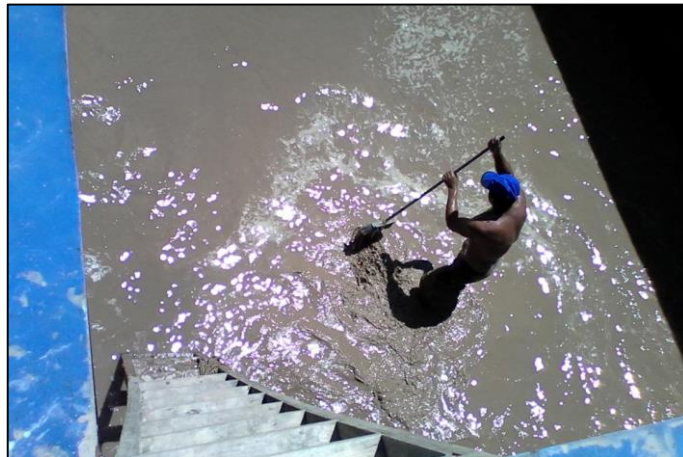
Fotografía N°2: Lodo acumulado durante el funcionamiento de la PTAP
