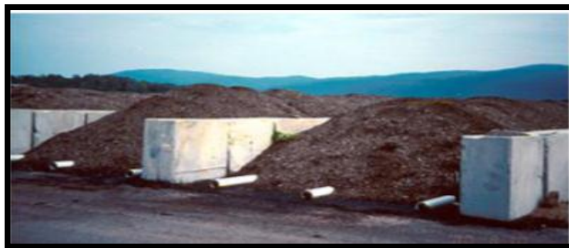
Imagen 2. Detalle de pilas estáticas con aireación pasiva.
