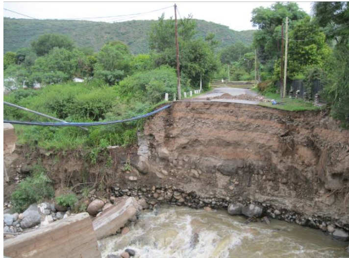
Foto 1: En El Rodeo calle y alcantarilla destruidos por el aluvión.
