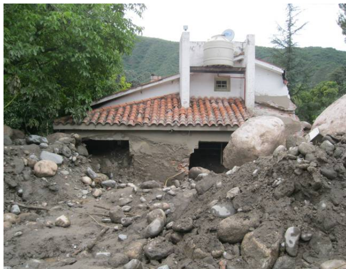
Foto 2: Casa de la localidad El Rodeo ubicada sobre la margen derecha del río aguas abajo del segundo puente, que fue en parte destruida y rellenada por el material de la inundación de detritos, se observa también el tamaño de los bloques que transporto el río.
