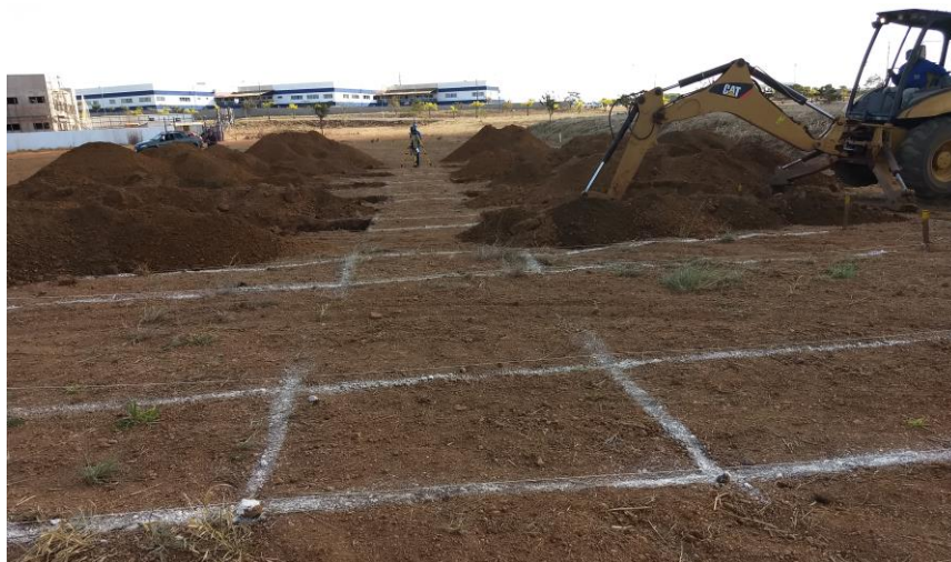
Figura 2 – Aspecto da delimitação e escavação mecânica das trincheiras na área do SCGRA-ENG da UEG/CCET.
