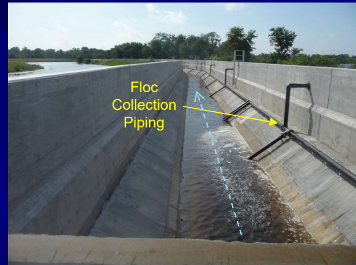
Floc Collection System
