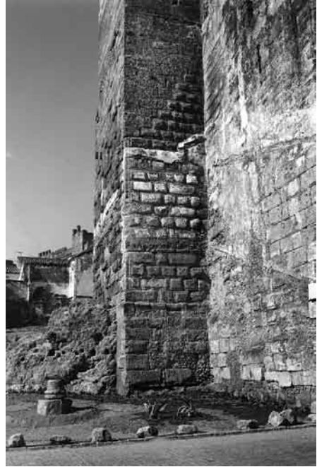
Fig. 6. Carmona. Puerta de Sevilla desde el sur. El nivel actual del suelo está por debajo del antiguo, de modo que los cimientos (saliente) de la torre del bastión se ven aproximadamente a la altura de la vista del fotógrafo.
