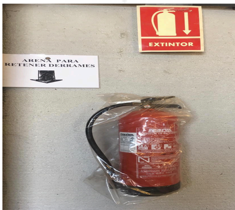
Fotografía 5: Extintor contra incendios
