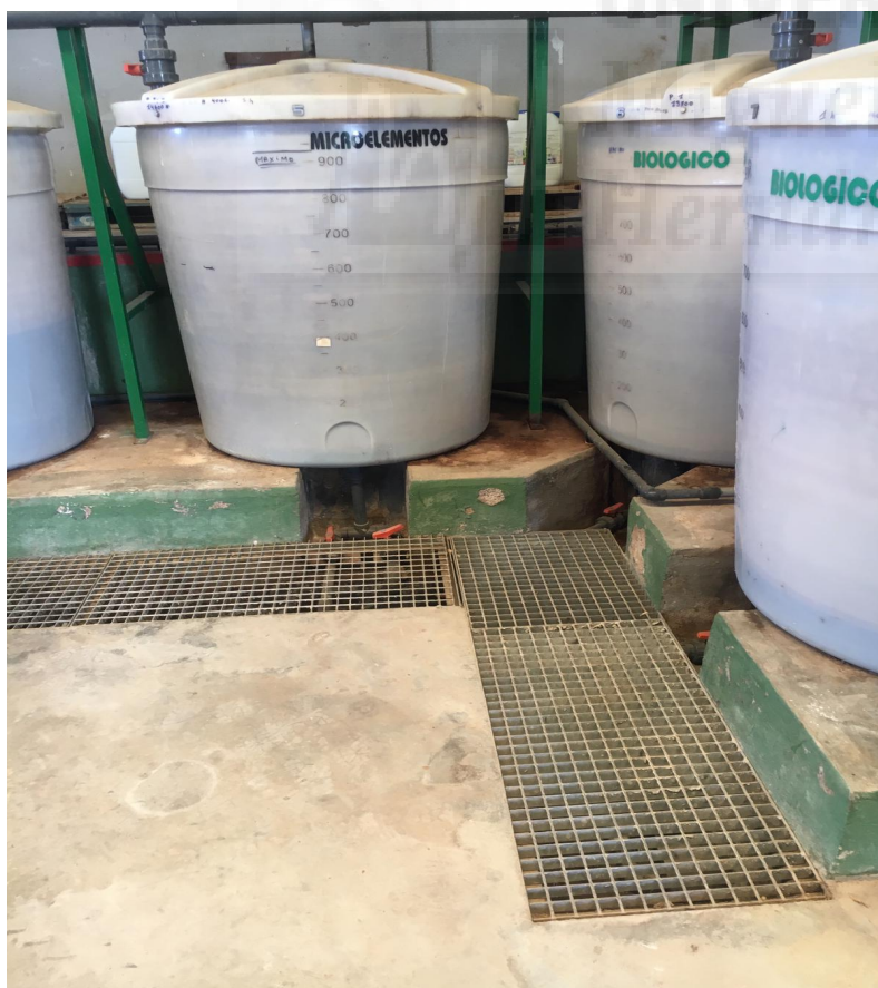
Fotografía 8: Tanques de productos de abono y rejillas antiderrame
