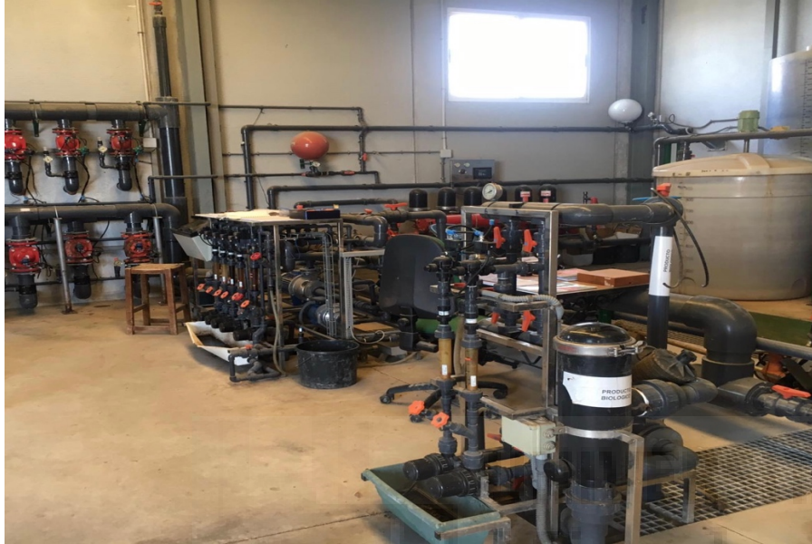
Fotografía 2: Cabezal de riego y tanques de productos de abono
