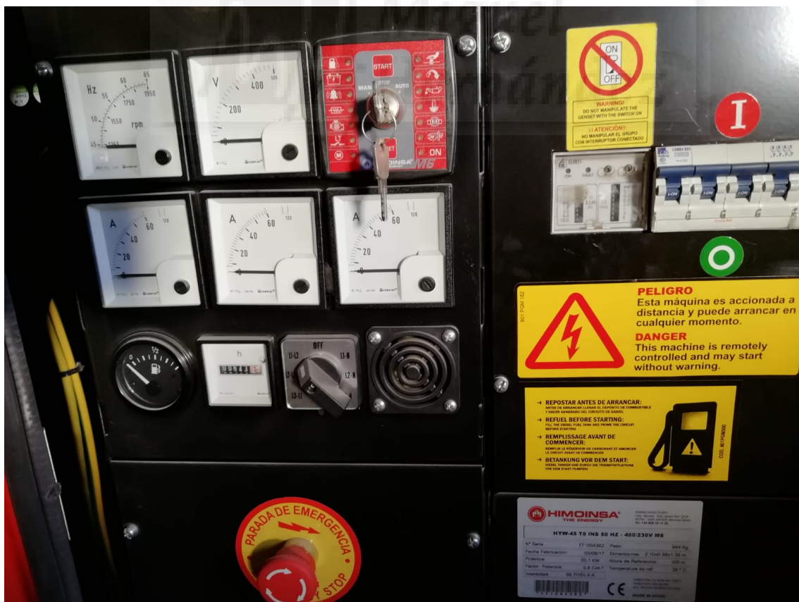
Foto 36: Cuadro eléctrico del grupo electrógeno
