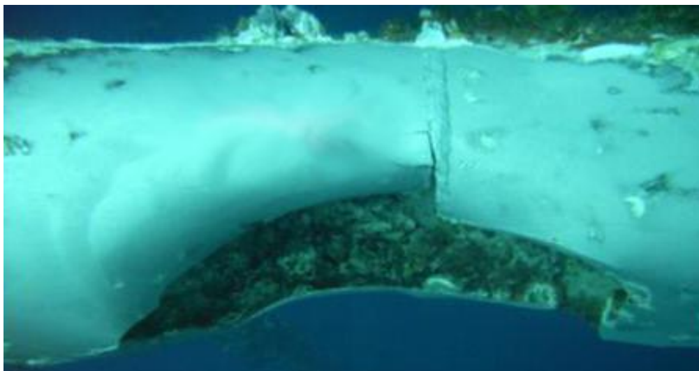
Рис. 1. Пример дефекта в подводной части конструкции морской платформы
