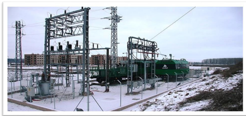
Figura 10: Subestaciones de intemperie.
