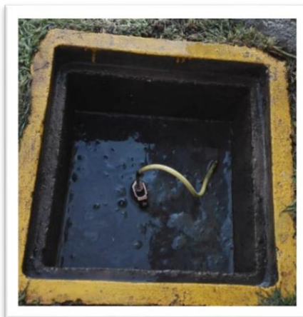
Figura 20: Ejemplo de puesta en tierra para subestación eléctrica.
