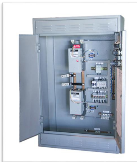
Figura 22: Ejemplo de Interruptor de transferencia en una subestación eléctrica.
