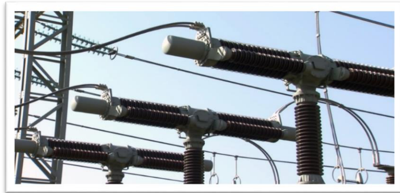
Figura 15: Ejemplo de Interruptor de potencia para subestación eléctrica.
