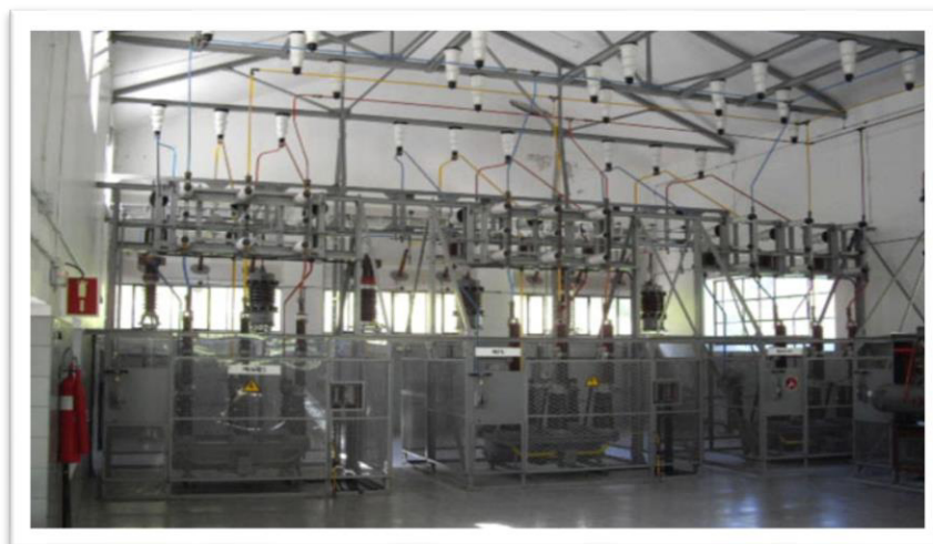
Figura 11: Subestaciones de interior
