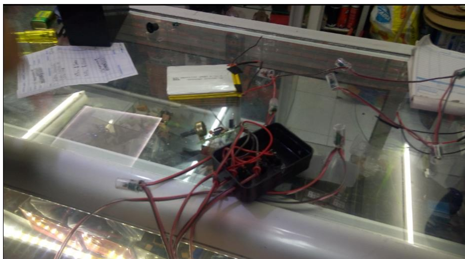
Figura 11. Sistema de carga eléctrico con batería de litio.
